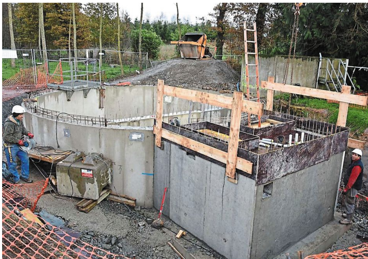
La station d'assainissement du Roc sera mise en service début avril. Cet équipement permettra au préfet de lever l'interdiction de construire sur la commune.
